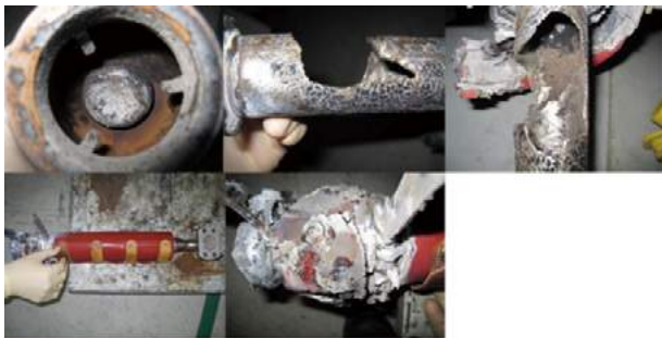
[Fig. 7] 기계식 진공 펌프의 스테인레스 스틸 배관이 내부 화학 반응에 의해 녹아내린 상태
